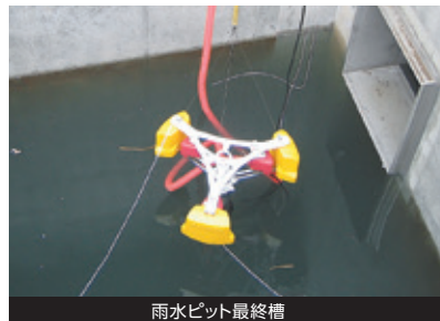
雨水ピット最終槽
